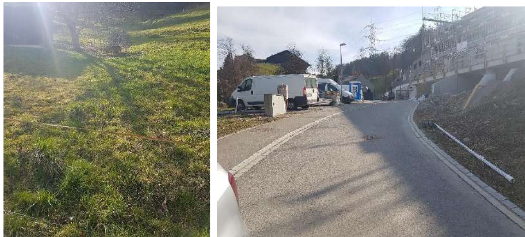
Abbildung 36: Eindolung ausserhalb Siedlungsgebiets (links) und Oberfläche entlang Hangstrasse (rechts)
