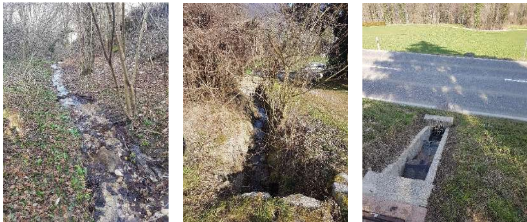
Abbildung 38: Bolbigraben im Waldstück (links), unterhalb erstem (Mitte) und zweitem (rechts) Durchlass
